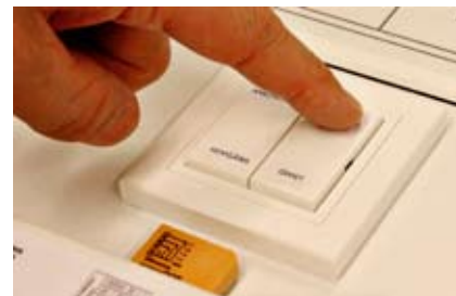
Manuell styrning via tryckknapp och DALI styrmodul
