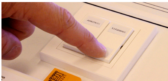
Manuell styrning via tryckknapp och DALI styrmodul
